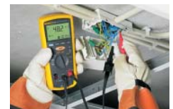
Test kabeláže v malé rozvodné skříni – vše v jednom bodě
